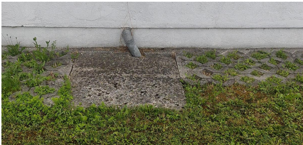
Слика бр. 23: Излазна цијев за технолошке отпадне воде
